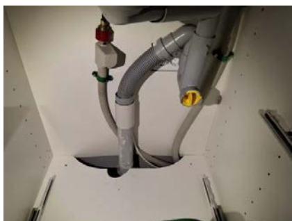
Boligen har synlige avløpsrør av plast.
