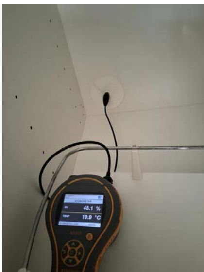
Bilde fra fuktmåling i veggkonstruksjon tilstøtende vætsone.
