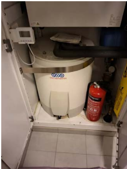
Varmtvannsbereder er plassert i teknisk skap.
