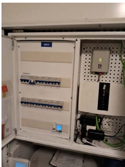
Sikringsskap med automatsikringer.
