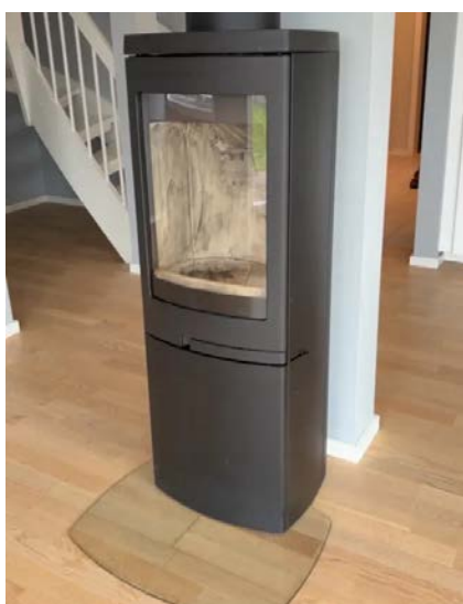
Vedovn med glassdør i stue.
