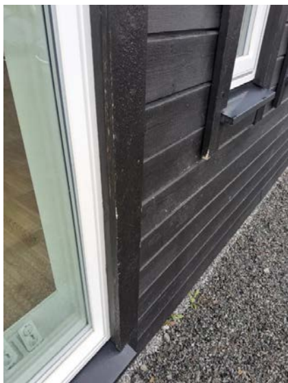
Kledningen er stedvis værslitt.
