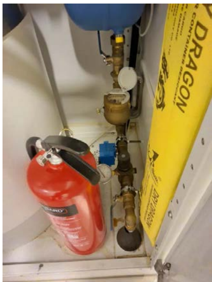
Hovedstoppekran er plassert i teknisk skap på vaskerom.
