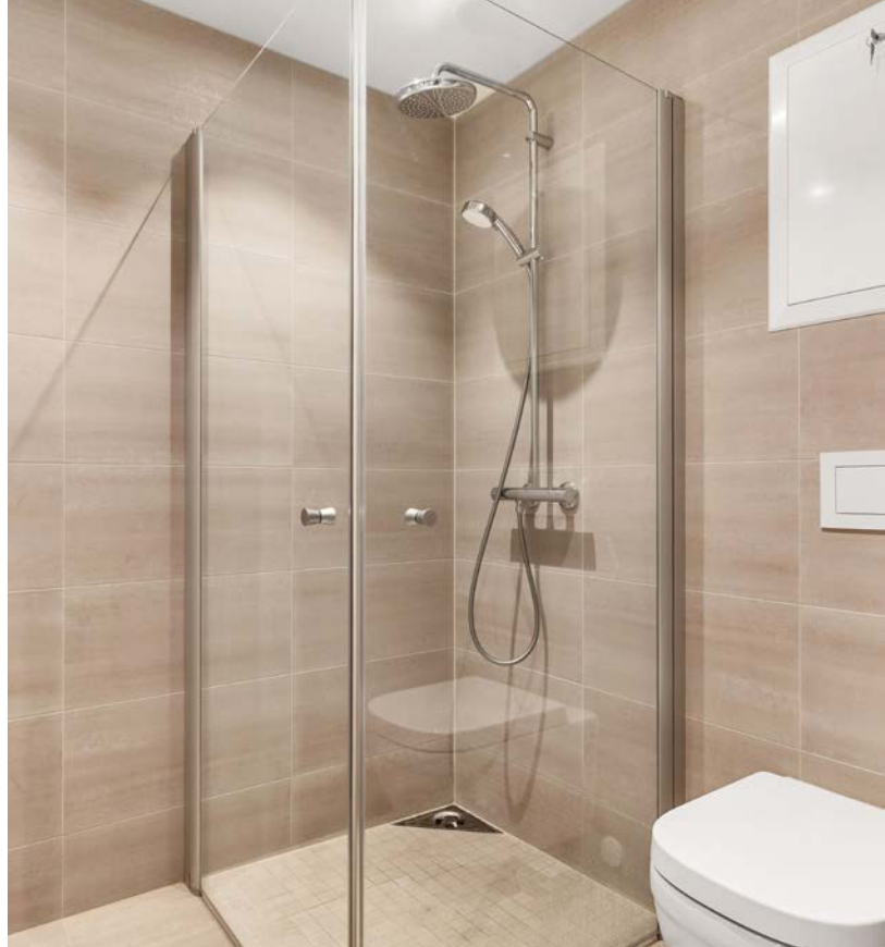
Veggmontert toalett og dusjhjørne med innfellbare dusjdører og vegghengt dusjbatteri med regnfall.
