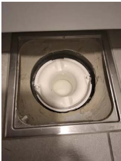
Plastsluk på vaskerommet.
