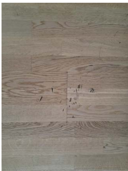
Hakk og skader i parkettgulv.
