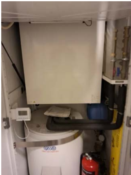
Ventilasjonsaggregat er plassert i teknisk skap.
