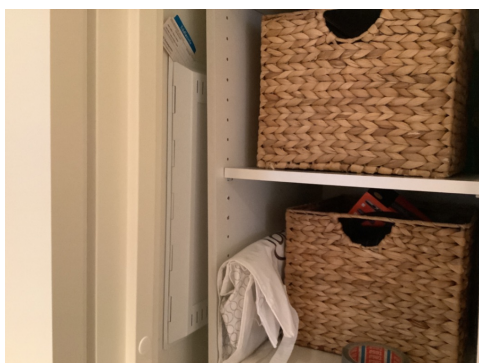
Sikringsskap plassert innenfor hylle i boden.
