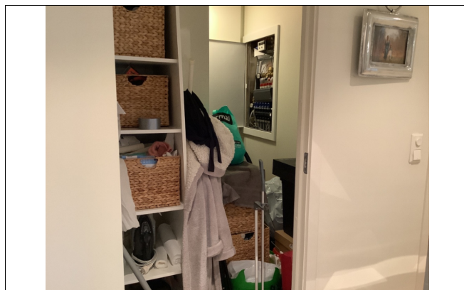
Svært mye løsere lagret i innvendig bord hindrer god kontroll av teknisk installasjoner, herunder rørinstallasjoner sikringsskap og ventilasjonsaggregat.
