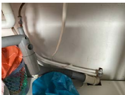
Manglende tetting inn i veggkonstruksjon.
