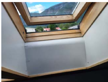
Sprekk i utforing.
