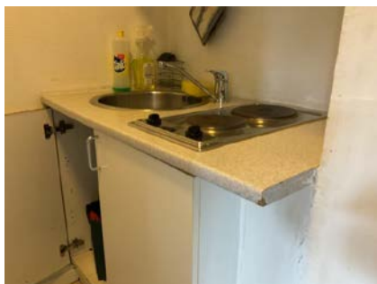
Skade på kjøkkenbenk.
