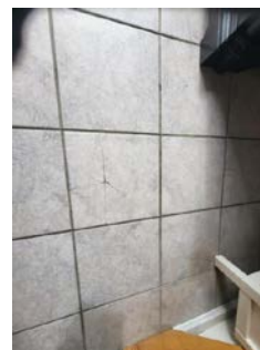
Sprekker i flis i hall i hovedinngang.
