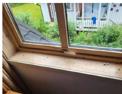
Fuktmerker i innvendig karm i loftvindu.
