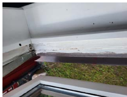
Oppsprekking i trevirke i karm.
