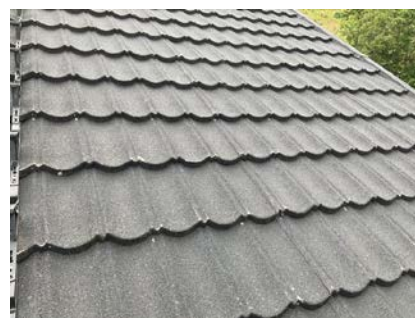
Slitasje på overflatebehandling av takplater.
