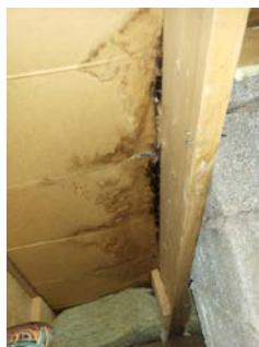
Fuktskade i undertak ved pipe.
