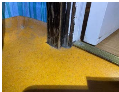
Belegget er kuttet mot utforing og sprekk ved dørlist.
