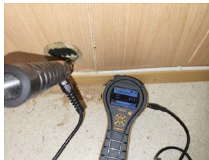
Fuktmåling i vegg med påviste forhøye fuktverdier.
