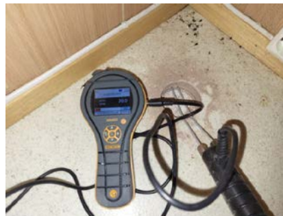
Fuktmåling i gulvplate med påviste forhøye fuktverdier.
