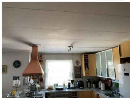
Falmet himling på kjøkken.
