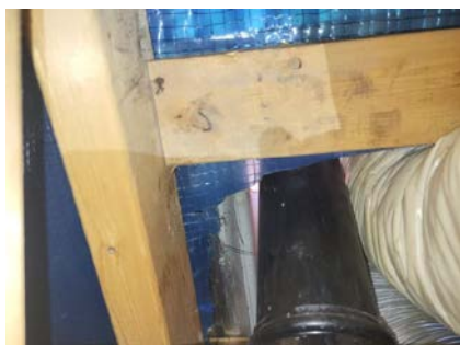
Åpent undertak ved ventilasjonsgjennomføring.
