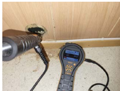
Fuktmåling i vegg med påviste forhøye fuktverdier.
