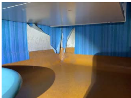
Overflate under innredning har skader.
