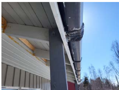
Takrenne er tettet med fugemasse.
