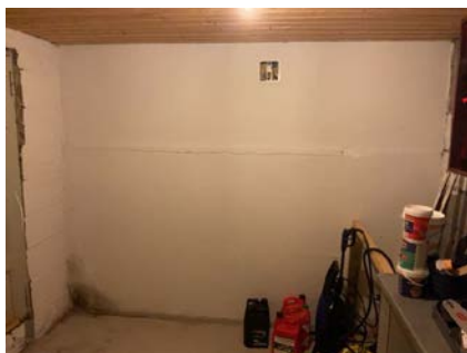
Fuktig vegg nede ved gulv.
