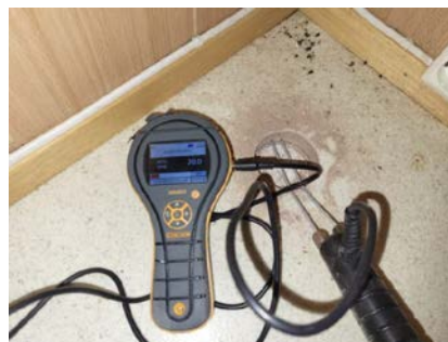
Fuktmåling i gulvplate med påviste forhøye fuktverdier.
