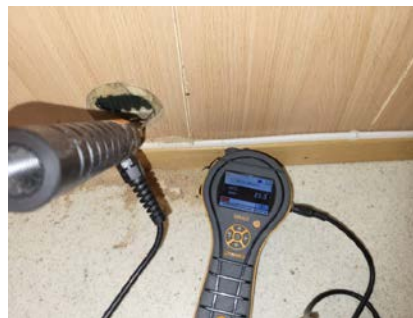
Fuktmåling i vegg med påviste forhøyede fuktverdier.
