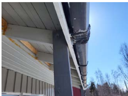
Takrenne er tettet med fugemasse.
