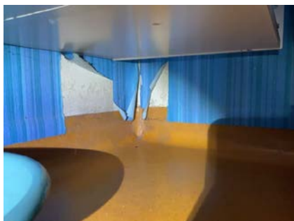
Overflate under innredning har skader.
