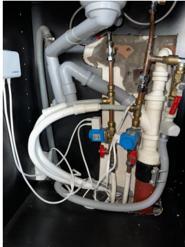
Røropplegg i kjøkkenbenk med Waterguard
