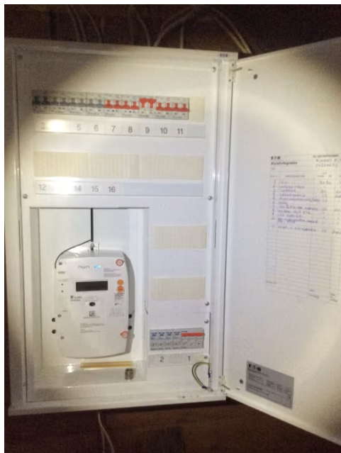
Sikringsskap i 2. etasje av nyere dato.
