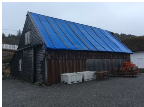
Nøst med omfattende slitasje.
