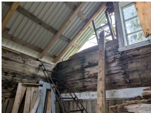
Aneks med dels manglende gavlvegg. Råte i alle konstruksjoner.
