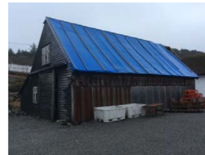
Nøst med omfattende slitasje.
