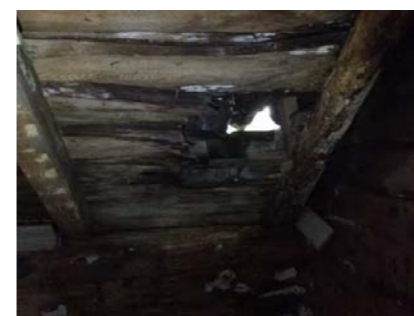
Flere hull og lekkasjer i yttertaket.
