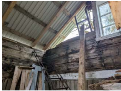
Aneks med dels manglende gavivegg. Råte i alle konstruksjoner.
