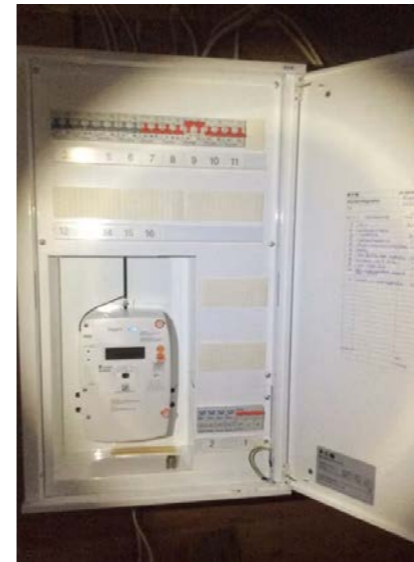
Sikringsskap i 2. etasje av nyere dato.
