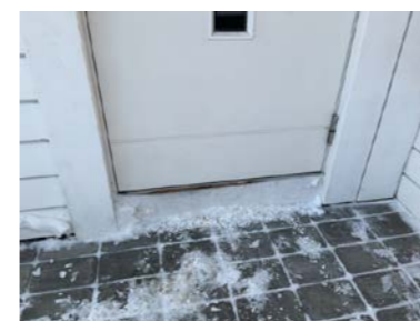
Manglende beslag under inngangsdør.
