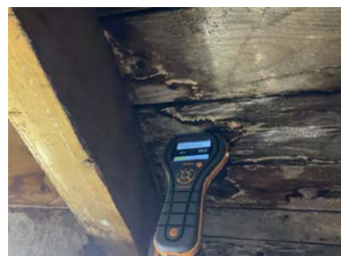
Det er registrert forhøyede verdier i undertak ved stikktakninger. Undersøkelser som er gjort er utført som stikktakning på tilfeldig valgte steder og sier kun noe om forholdene på stedet hvor undersøkelsene er gjort.
