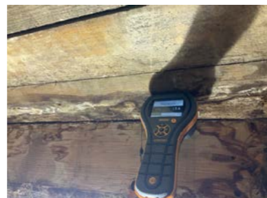
Muggsopp registrert stedvis på undertak, symptomer på fuktgjennomtrengning.
