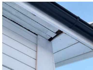
Større åpninger i gessimsbord gjør det mulig for skadedyr å ta seg inn i konstruksjonen.
