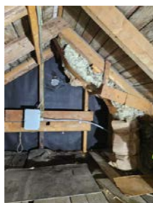
Ventilasjonsrør/lufterør har er isolert ufagmessig. Det anbefales å isoleres rør/kanaler med en type isolasjonsstrømpe for å minske risikoen for kondens/fuktskader rundt rør.
