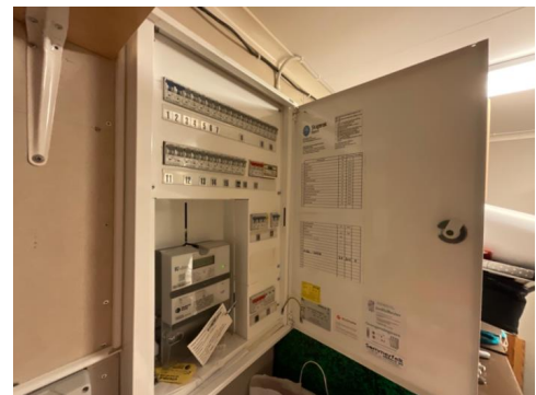
Sikringsskap i bod i kjelleren
