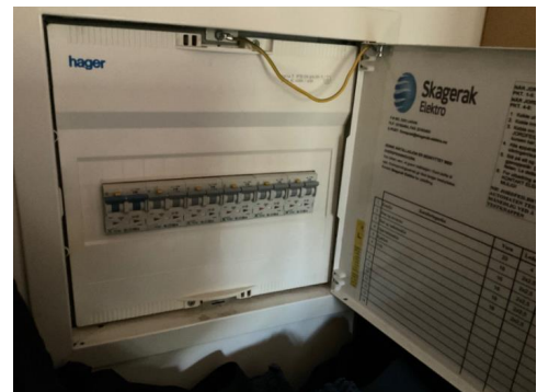
Sikringsskap i leilighet
