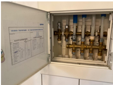
Rør i rør skap 1. etasje
