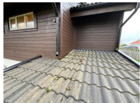
Manglende beslag på takoverbygg
