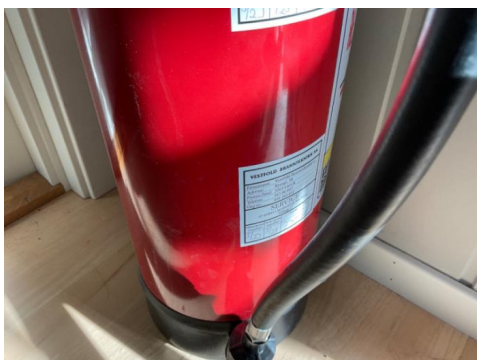
Slokkeapparat i 2. etasje
