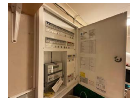
Sikringskap i bod i kjelleren
