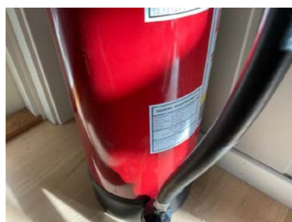
Slokkeapparat i 2. etasje
