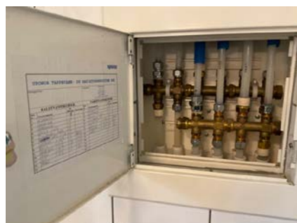
Rør i rørskap 1. etasje
