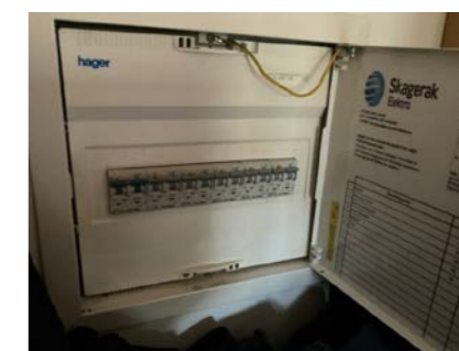
Sikringskap i leilighet
