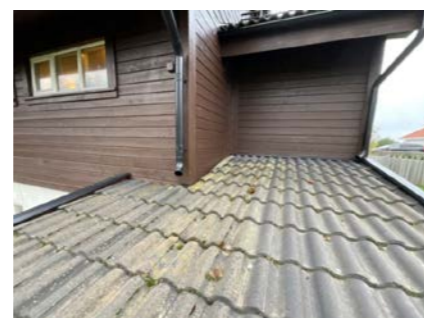
Manglende beslag på takoverbygg
