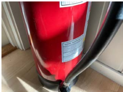
Slokkeapparat i 2. etasje
