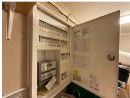
Sikringsskap i bod i kjelleren
