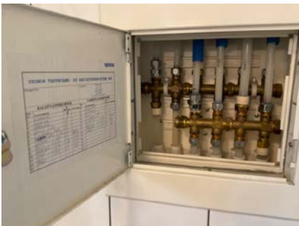
Rør i rør skap 1. etasje
