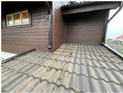
Manglende beslag på takoverbygg
