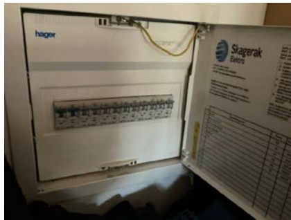
Sikringskap i leilighet
