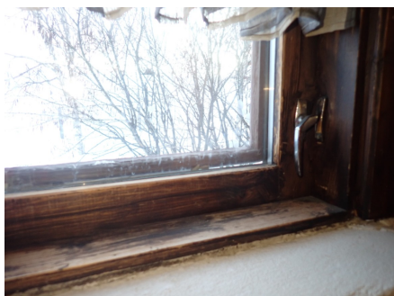
Bodvindu med tegn på punktert glass.
