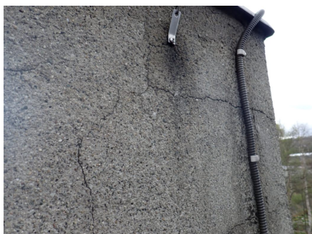
Bilde fra befaring i 2023. Viser mindre riss/sprekker i pipe over tak.
