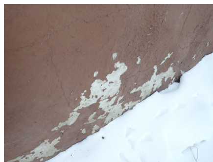
Noe riss og avskalling.
