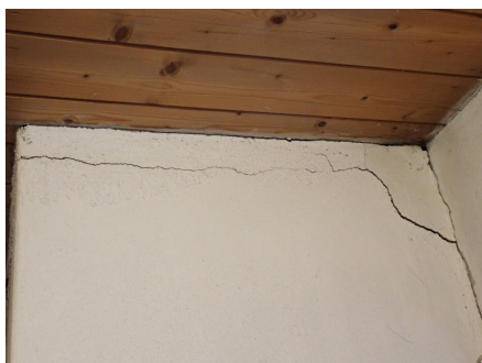
Oppsprekking i pipemur.
