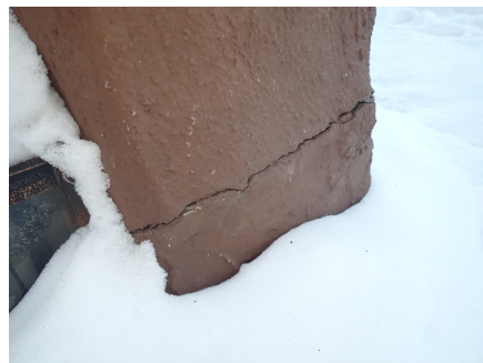
Sprekkdannelse ved fundament.
