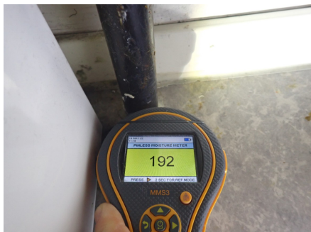
Utslag på fukt i gulv.
