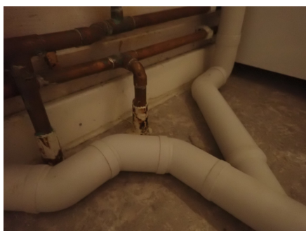
Kun fugemasse i overgang mot vegg.
