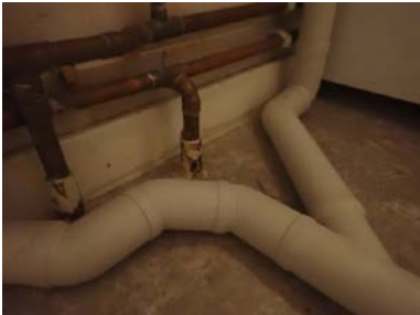
Kun fugemasse i overgang mot vegg.
