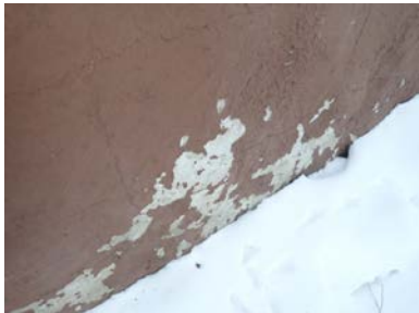
Noe riss og avskalling.
