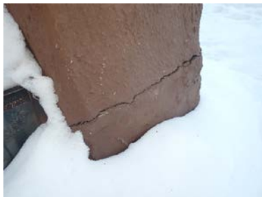
Sprekkdannelse ved fundament.
