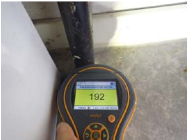
Utslag på fukt i gulv.
