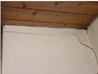
Oppsprekking i pipemur.
