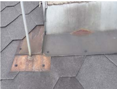
Bilde fra befaring i 2023. Viser rust på beslag.
