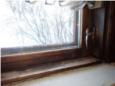
Bodvindu med tegn på punktert glass.
