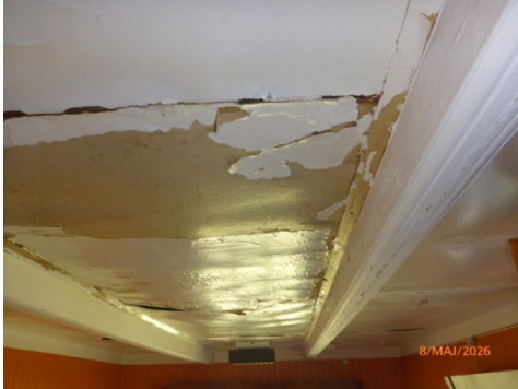
Fuktskader i kjøkkenhimling ved pipe.
