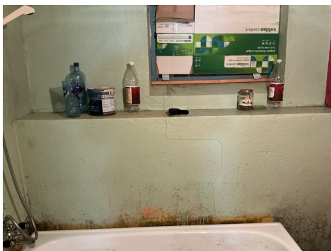
Viser sprekk i vegg i våtsone.
