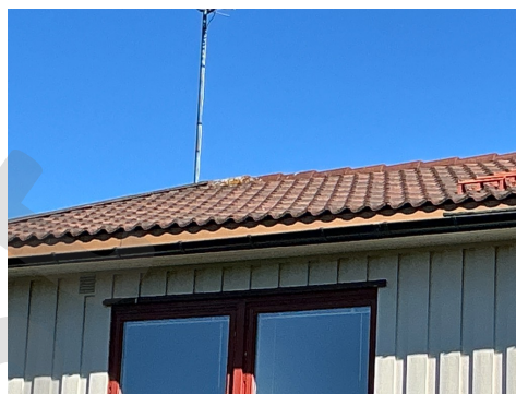
Viser mosedannelse på hovedtaket.
