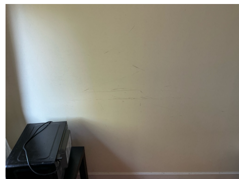
Viser merke på soverom i 1.etg.
