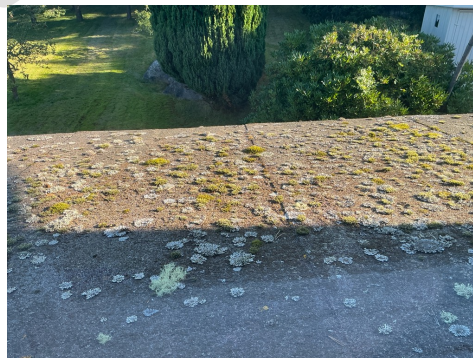
Viser mosedannelse på tak over veranda.
