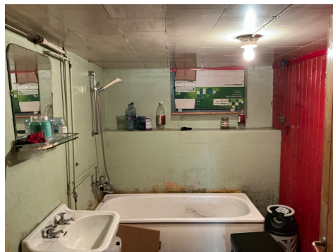
Viser bad med muggsopp på vegger.
