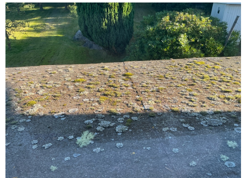
Viser mosedannelse på tak over veranda.
