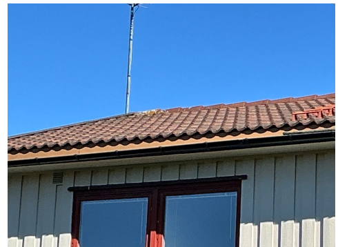
Viser mosedannelse på hovedtaket.
