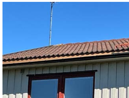
Viser mosedannelse på hovedtaket.
