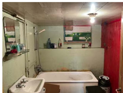
Viser bad med muggsopp på vegger.
