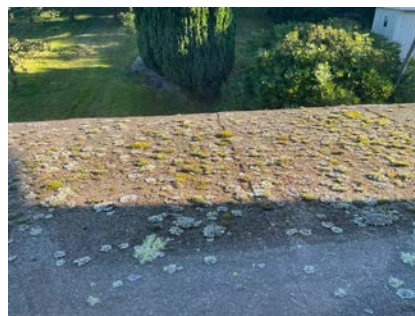
Viser mosedannelse på tak over veranda.
