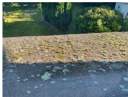
Viser mosedannelse på tak over veranda.
