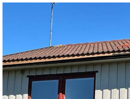
Viser mosedannelse på hovedtaket.
