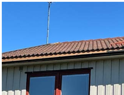
Viser mosedannelse på hovedtaket.
