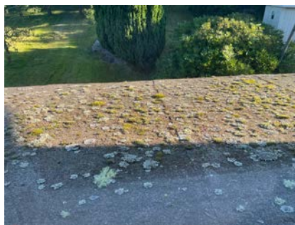
Viser mosedannelse på tak over veranda.
