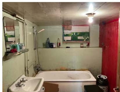
Viser bad med muggsopp på vegger.
