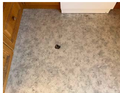
Viser sår i gulv på kjøkken.
