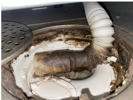
Plastsluk, uten synlig slukmansjett.
