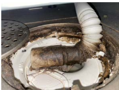
Plastsluk, uten synlig slukmansjett.
