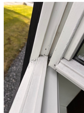
Oppsprekking av maling utvendig
