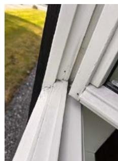
Oppsprekking av maling utvendig
