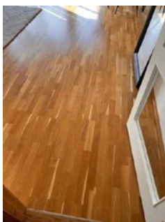
Svikt i gulv ved inngang til stue.
