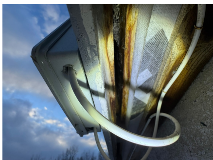
Det er ikke tegn til musesperre i nedkanten av kledningen på veggen ned mot veien.
