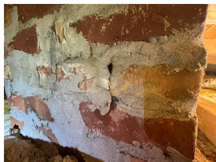
Riss i pipen på kaldloftet.
