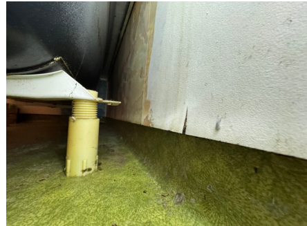
Råteskader i nedkanten av baderomsplatene.
