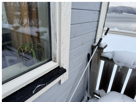
Eksempel på værslitt vindu.
