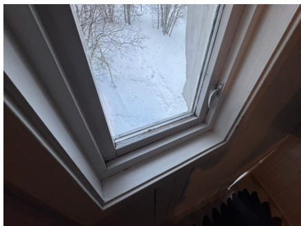
Tegn til innvendig kondensering.
