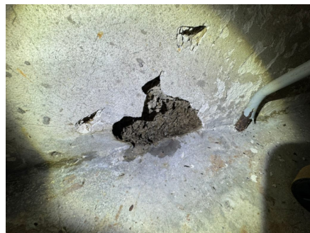
Synlig fuktighet hvor det er synlig tresonitt.
