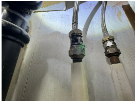
Drypplekkasje fra rørkobling.
