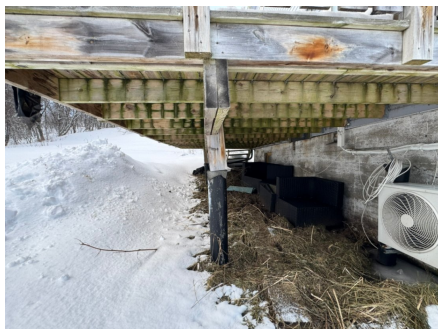
Skjevheter i søyle og langt overheng på bjelkene.
