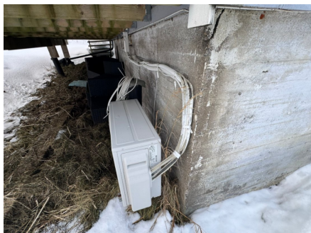
Rør som ikke er klamret tilstrekkelig fast med skadet isolasjon.
