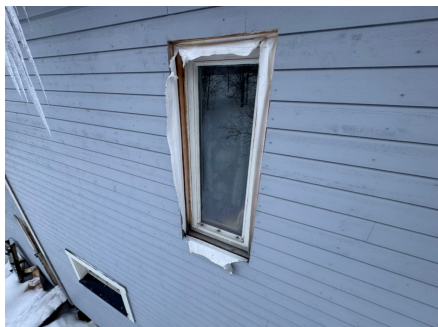
Eksempel på vindu som ikke er ferdigstilt utvendig.
