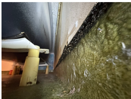
Råteskader i nedkanten av baderomsplatene.
