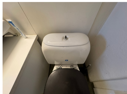
Toalettet mangler løfteknapp.
