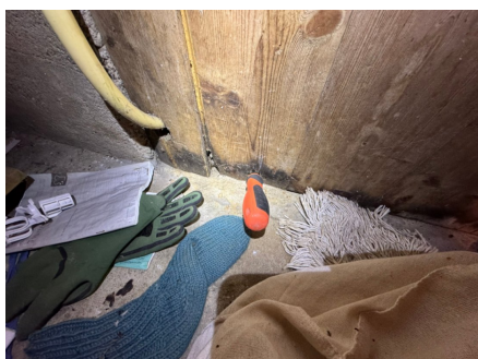
Råteskader i nedkanten av veggen.
