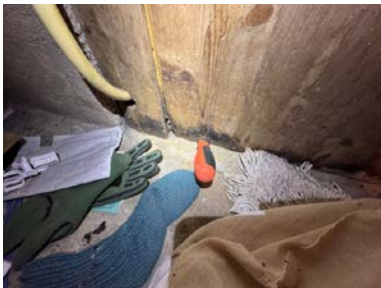
Råteskader i nedkanten av veggen.
