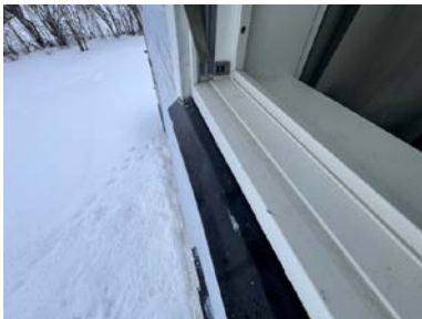
Eksempel på skadet beslag.
