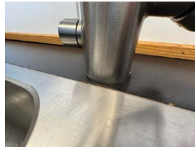
Delaminering ved kjøkkenkranen.
