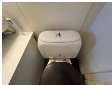
Toalettet mangler løfteknapp.
