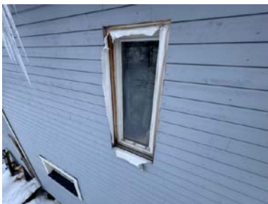
Eksempel på vindu som ikke er ferdigstilt utvendig.
