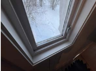
Tegn til innvendig kondensering.
