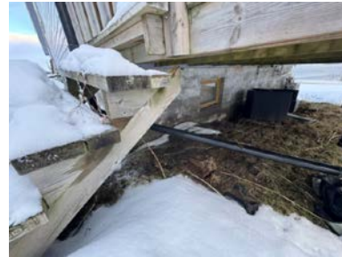
Trappen er skadet.
