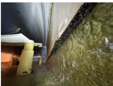
Råteskader i nedkanten av baderomsplatene.
