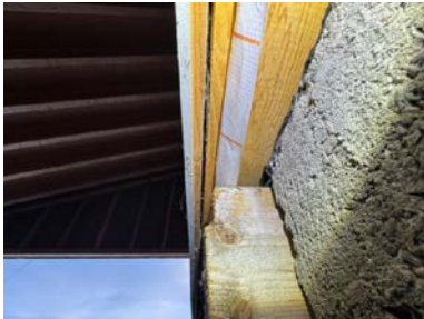
Vindesperren er ikke lagt rundt lektene på utforingen.
