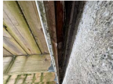
Konstruksjonen ser ut til å være begrenset ventilert ved altanen.
