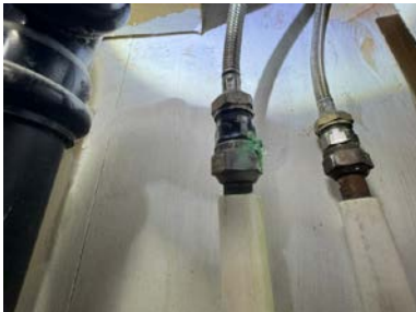
Drypplekkasje fra rørkobling.
