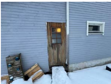
Døren er ikke ferdigstilt med beslag og omramming.
