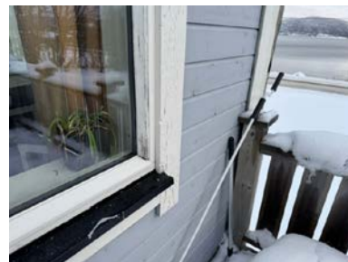
Eksempel på værslitt vindu.
