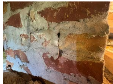
Riss i pipen på kaldloftet.
