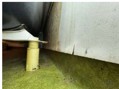
Råteskader i nedkanten av baderomsplatene.
