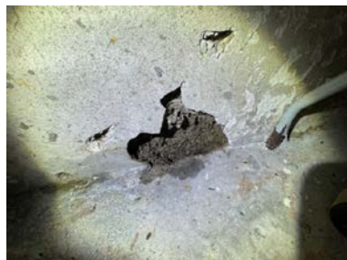
Synlig fuktighet hvor det er synlig tresonitt.
