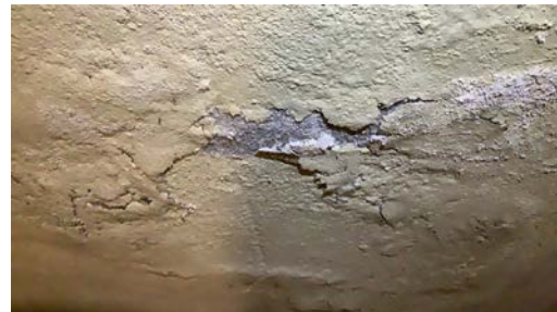
Eksempel på saltutslag.
