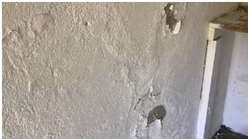
Eksempel på saltutslag.
