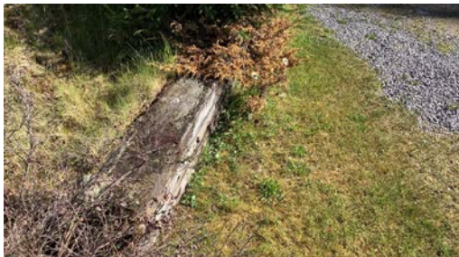
Forstøtningsmur av jernbanesviller har skjevheter.
