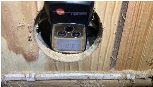
Hulltaking, og treverk er vått.
