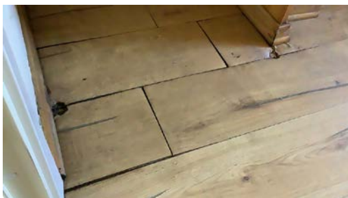
Fuktskadet laminatgulv på kjøkken.
