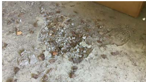
Skader i betonggulv.
