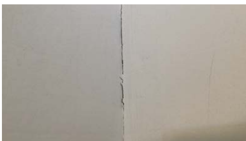
Sprekk i maling på veggoverflate.
