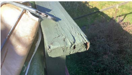
Råteskader i håndløper.
