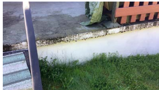
Deler av takterrassen mangler rekkverk.
