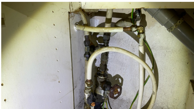
Lekkasje fra rørskjøt på kobberør over stoppekran.
