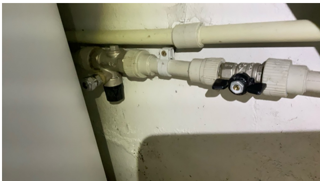
Lekkasje på vannrør på vaskerommet.
