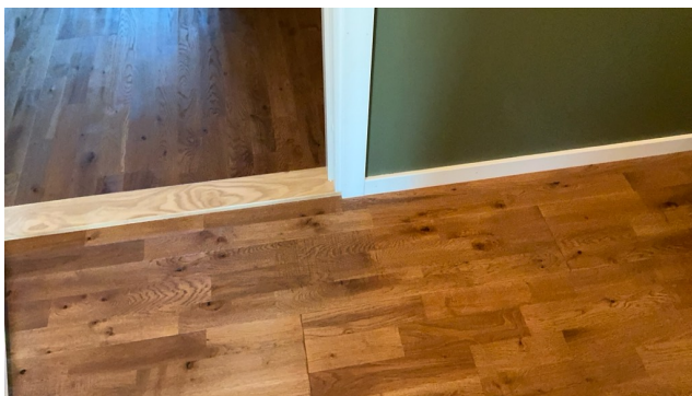
Knirk i gulv ved dør til soverom
