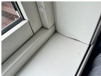
Fuktsvelling på foringer og merker etter kondensvann på glassramme.
