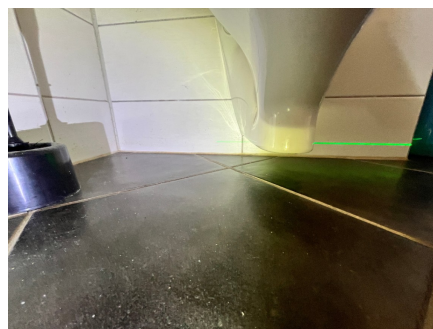
Ikke drenerings åpning under toalett.
