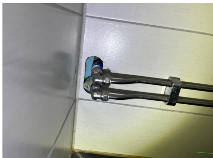
Utett rundt rør i vegg
