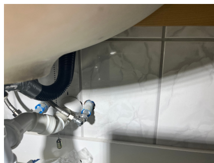
Ikke tett rundt rør i vegg.
