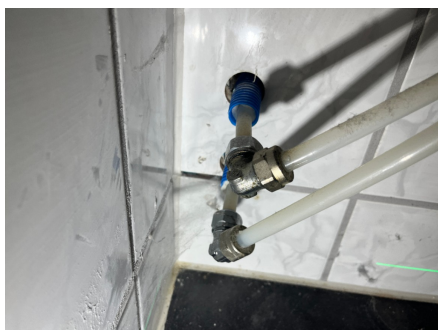
Ikke tett rundt rør i vegg.
