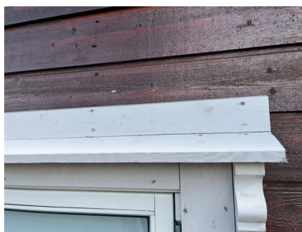
Ikke beslag på vannbrett over vindu, u\kjent løsning på tetting for regn og vind.
