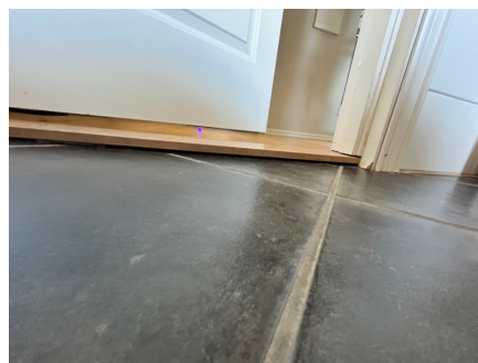
Ikke vanntett oppkant under døren, fuktsvelling på foring.
