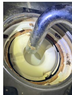
Synlig slukmansjett under klemring i sluket
