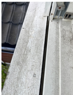
Vannbrett montert feil og uten beslag.
