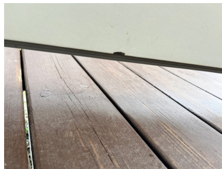
Skade på ytterdør 1 etasje
