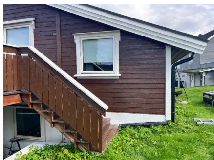
Hjørne der det kommer inn fukt
