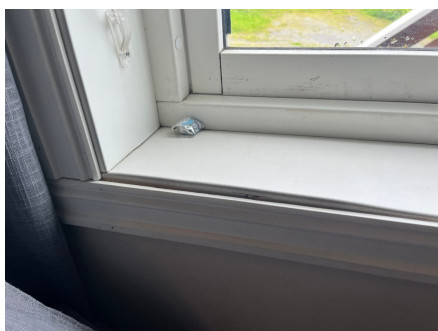
Fuktsvelling på foring
