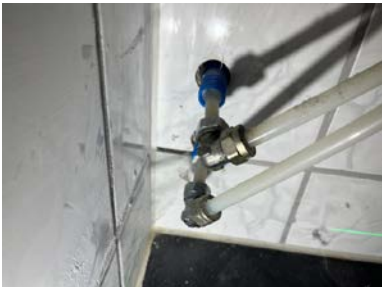
Ikke tett rundt rør i vegg.
