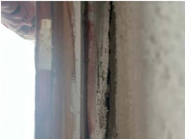
Ingen lufting i nedkant på vegg
