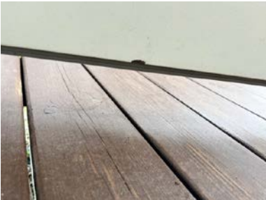
Skade på ytterdør 1 etasje
