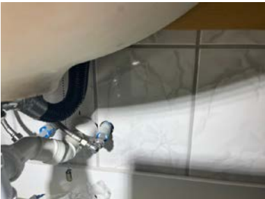
Ikke tett rundt rør i vegg.
