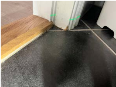
Ikke vanntett oppkant under dør, fuktsvelling på foringer
