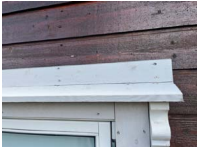
Ikke beslag på vannbrett over vindu, u\kjent løsning på tetting for regn og vind.
