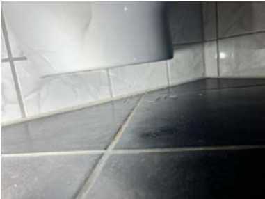
Ikke drenerings åpning under toalett.
