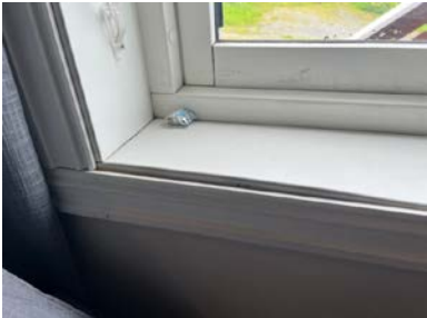
Fuktsvelling på foring
