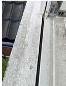
Vannbrett montert feil og uten beslag.
