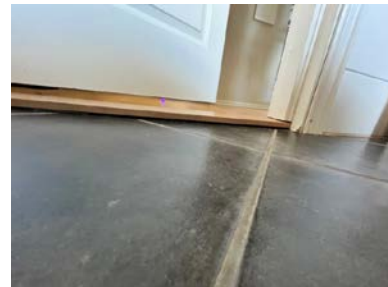
Ikke vanntett oppkant under døren, fuktsvelling på foring.
