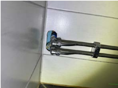
Uttett rundt rør i vegg
