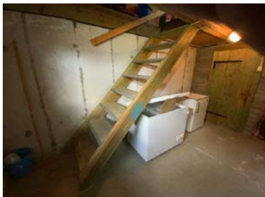
Mangler rekkeverk på kjellertrapp.
