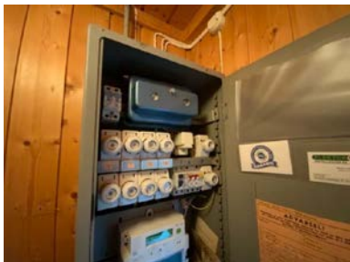
El-skap med skrusikringer.
