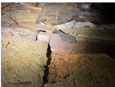
Varierende isolering på loftet.
