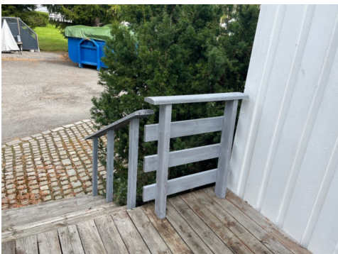
Rekkverk er ustabilt.
