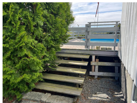
Trapp uten rekkverk, som trenger behandling.
