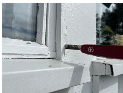
Dekkbord med råte.
