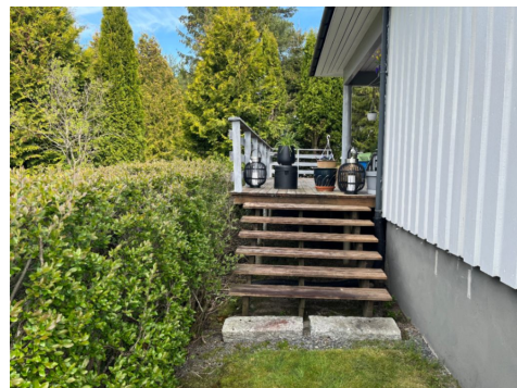
Trapp uten rekkverk og håndløper.
