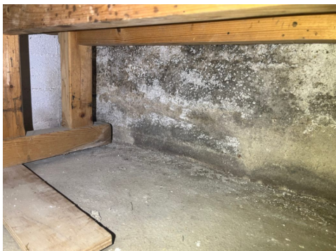
Det er påvist saltutslag på vegger.
