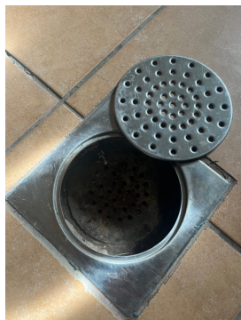
Slukrist over eldre sluk med rist.
