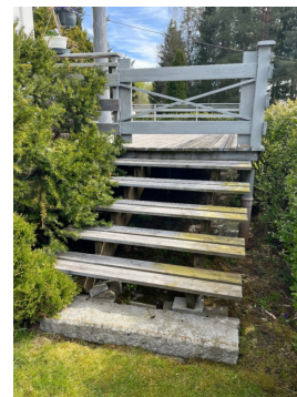
Trapp uten rekkverk med løse trinn.
