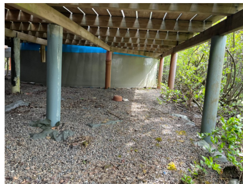
Bærebjelker og bjelkelag er underdimensjonert.
