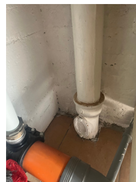
Avløpsrør av støpejern og stakeluke.
