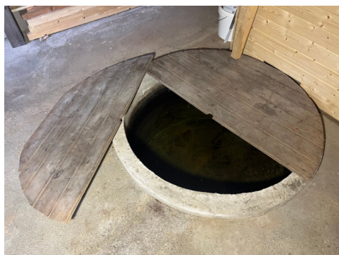
Brønn med vann fra ile i kjeller.
