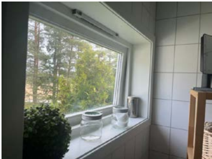
Vindu med punktert glass,
