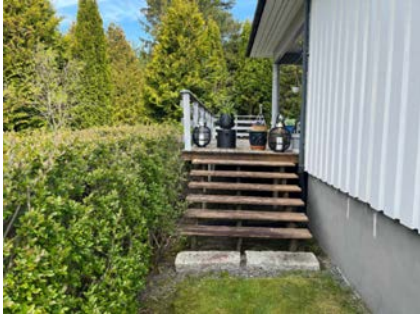
Trapp uten rekkverk og håndløper.
