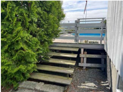
Trapp uten rekkverk, som trenger behandling.
