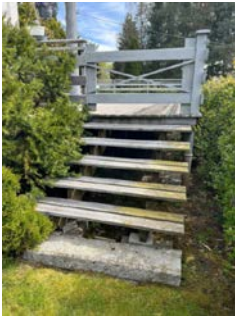
Trapp uten rekkverk med løse trinn.
