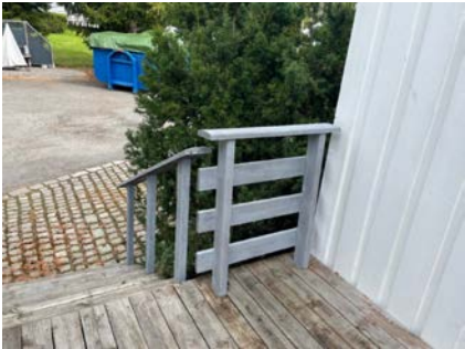
Rekkverk er ustabil.
