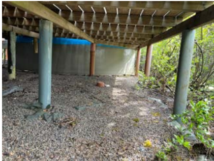
Bærebjelker og bjelkelag er underdimensjonert.
