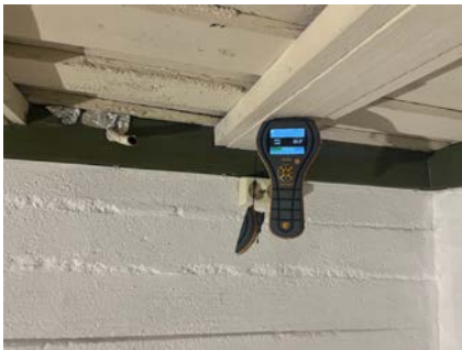
Fuktmålinger viste normale verdier.
