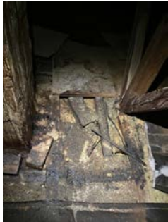
Det bør rengjøres rundt pipe på loft.
