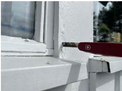
Dekkbord med råte.
