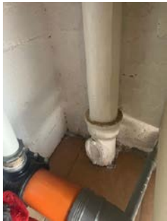
Avløpsrør av støpejern og stakeluke.
