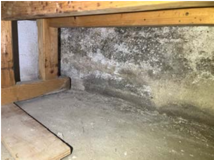
Det er påvist saltutslag på vegger.
