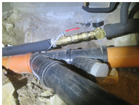
Stoppekran i krypkjeller.
