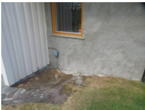
Område med fall mot grunnmur.
