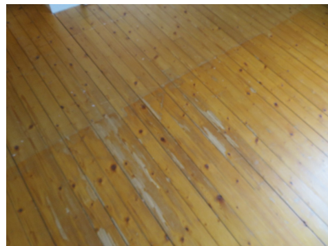
Slitasje i tregulv i 2.etg.
