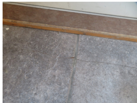
Sprekk i gulvfliser ved ytterdør i 1. etg.
