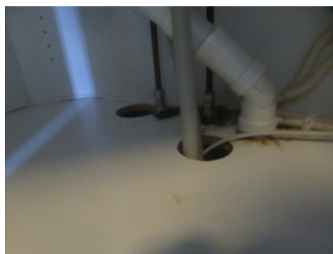
Vannrør i kobber.
