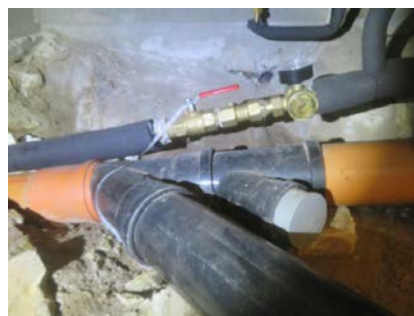
Stoppekran i krypkjeller.
