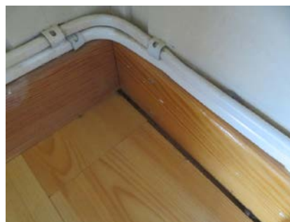
Klaring mellom laminatgulv og gulvlist i stue i 1. etg.
