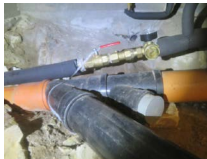
Stoppekran i krypkjeller.
