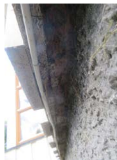
Lite lufting i nedkant av trepanel.
