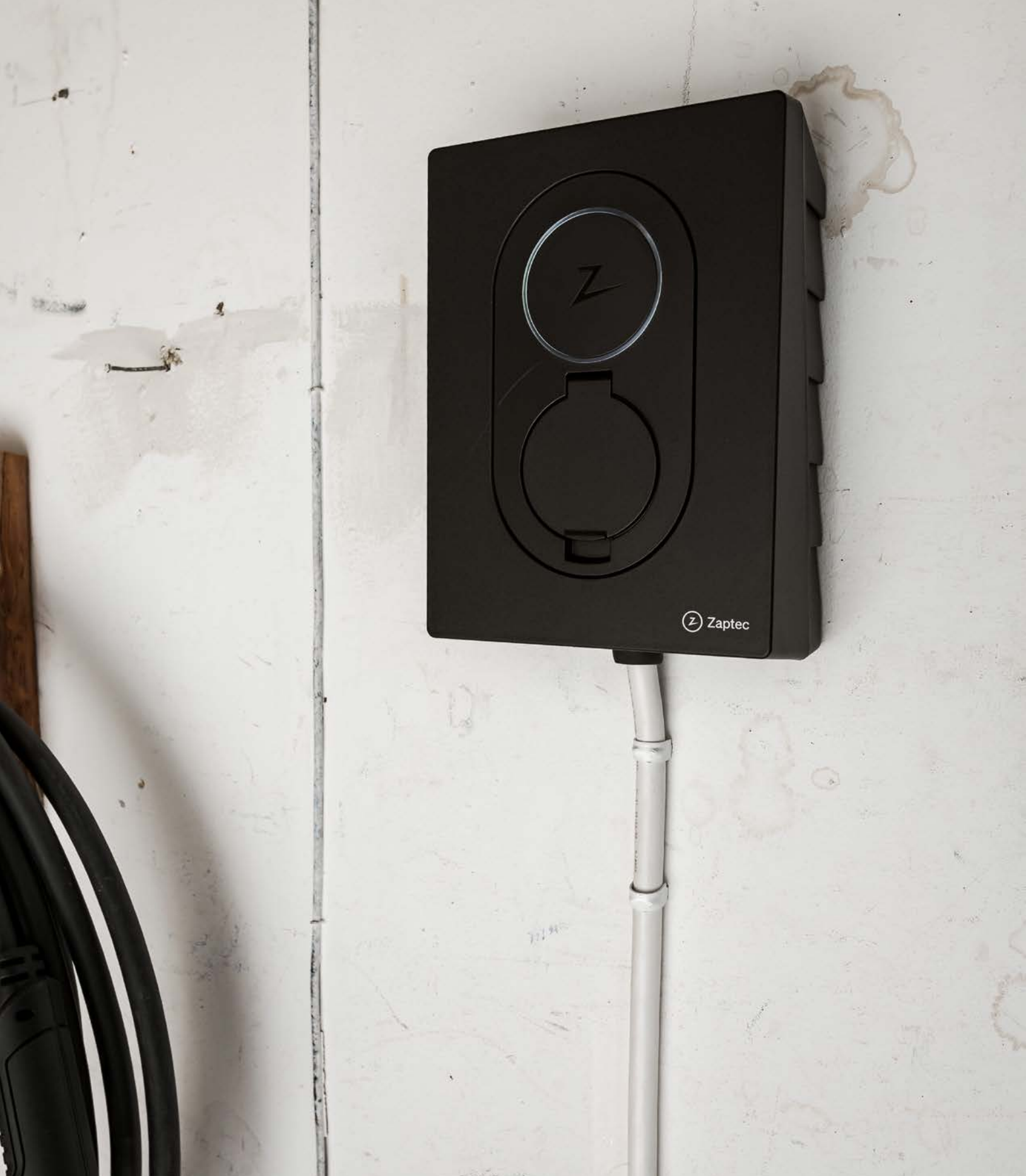
Det er montert el-billader i garasjen.
