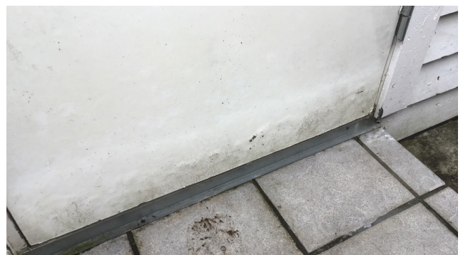
Fukt skader i nedkant
