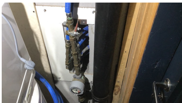
Vannmåler og stoppekran i kjeller
