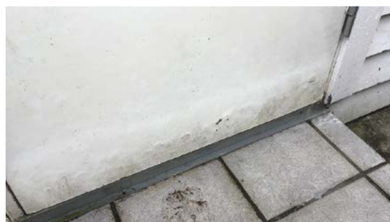
Fukt skader i nedkant
