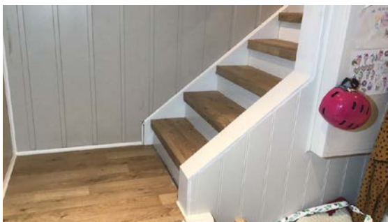
Mangler rekkverk på den nederste delen
