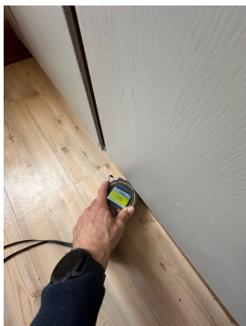
Forhøyet fuktverdi ved vask på kjøkken
