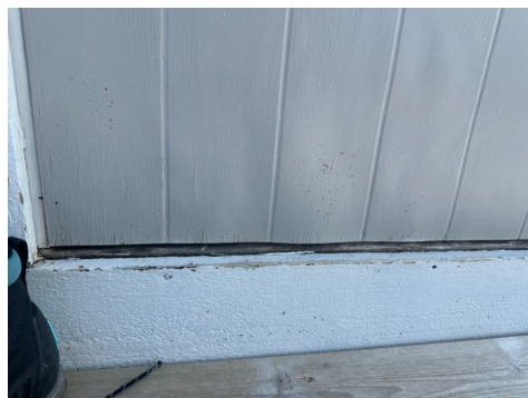
Oppsvulmet dørblad ytterdør
