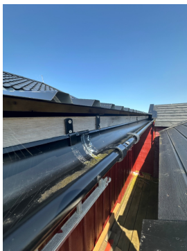
Manglende takfotbeslag utebod
