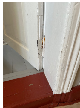
Flere skader på innvendige dører
