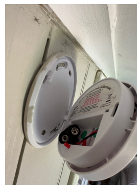
Røykvarsler mangler batteri. Ikke funksjonstestet.
