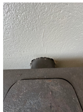
Utetthet i rørgjennomføring mot skorstein
