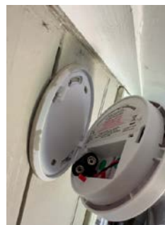
Røykvarsler mangler batteri. Ikke funksjonstestet.
