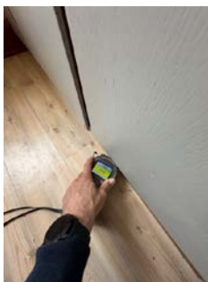
Forhøyet fuktverdi ved vask på kjøkken
