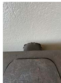
Utetthet i rørgjennomføring mot skorstein
