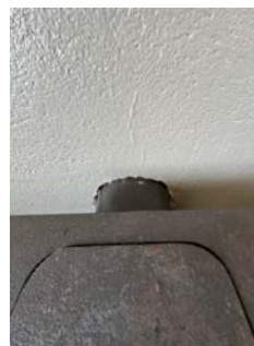
Utetthet i rørgjennomføring mot skorstein
