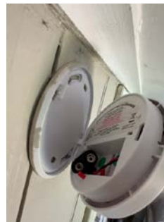
Røykvarsler mangler batteri. Ikke funksjonstestet.
