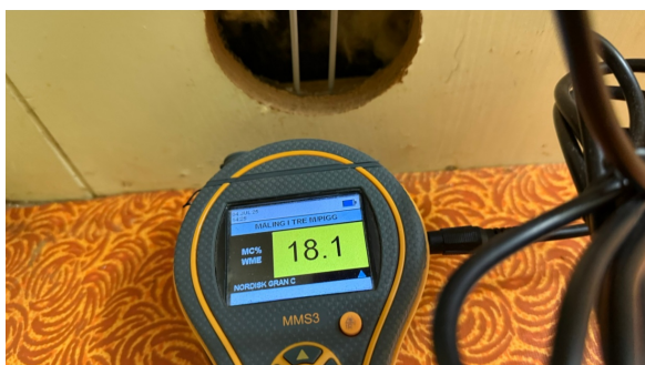
Fuktmåling i utforet vegg under terreng
