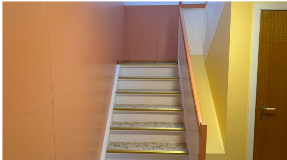
Det mangler håndløper på en side i trappen
