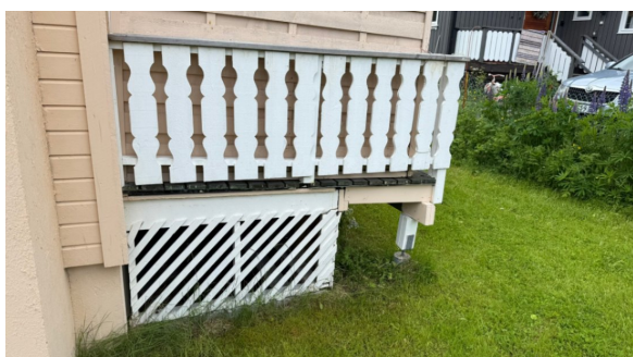
Bildet viser skjevheter i konstruksjonen
