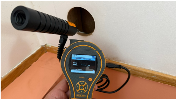
Fuktmåling i vegg mot badekaret
