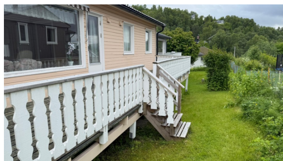
Bildet viser skjevheter i konstruksjonen
