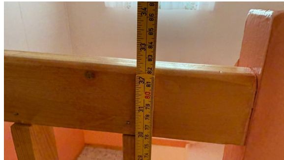
Rekkverket er 82cm høyt. Kravet på oppføringstidspunktet var 90cm
