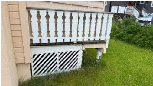
Bildet viser skjevheter i konstruksjonen
