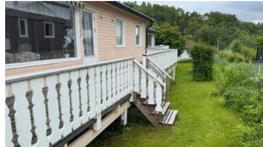
Bildet viser skjevheter i konstruksjonen
