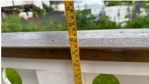
Rekkverket er 80cm. På oppføringstidspunktet for verandaen var kravet 90 cm.
