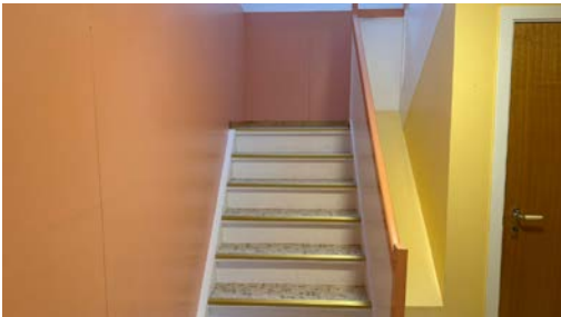
Det mangler håndløper på en side i trappen
