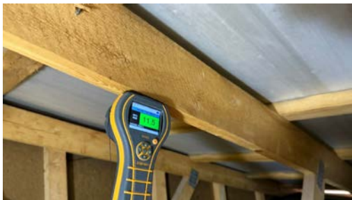
Fuktmåling i sperre. Bildet viser også at undertaket er montert over lekteren, noe som er feil utførelse.
