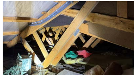
Manglende brannskille mot naboseksjonen.
