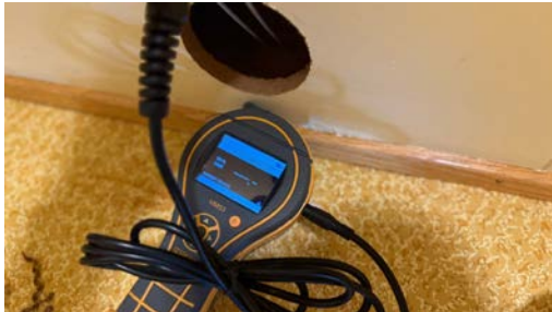
Fuktmåling i vegg inn mot vaskerommet
