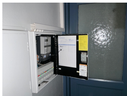
Automatsikringer i sikringsskap plassert i gang/fellesareal.
