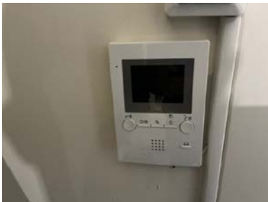
Dørcalling med monitor er plassert i entre.
