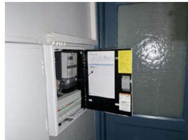
Automatsikringer i sikringsskap plassert i gang/fellesareal.
