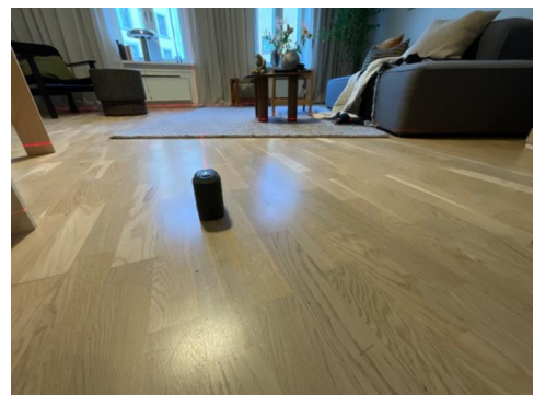
Nivellering stue, avvik ca. 10-20 mm
