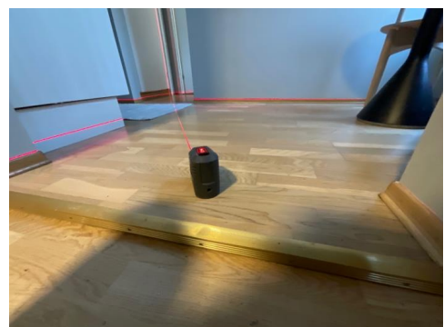
Nivellering kjøkken, avvik ca. 10 mm
