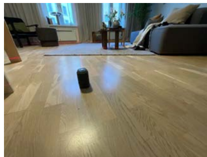
Nivellering stue, avvik ca. 10-20 mm
