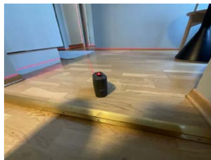
Nivellering kjøkken, avvik ca. 10 mm
